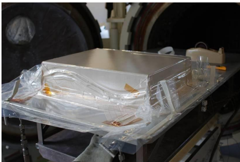
Figur 6.1.8: Øverst og midt: Efter oplæg af materiale bliver den øverste form forsigtigt løftet på plads ved hjælp af en kran. Nederst: Vakuumpakning af formdelene med transparent vakuumfolie (Airtech, Wrightlon 5400) og hvid tætningsmasse (Airtech, GS 43 MR).
